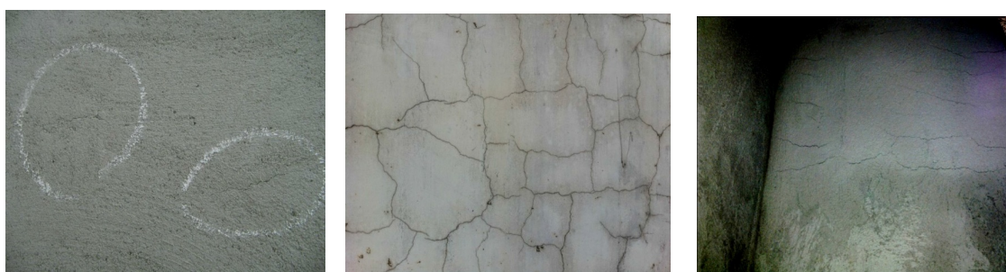
图 7.1-1 局部砂浆层太厚 图 7.1-2 收缩龟裂纹 图 7.1-3 超过开放时间
