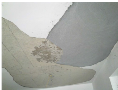
图 7.2-3 砂浆再次剥落
