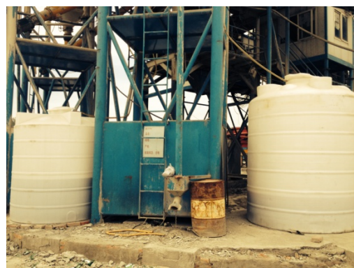
图 1.3-2 增加砂浆专用外加剂储罐
